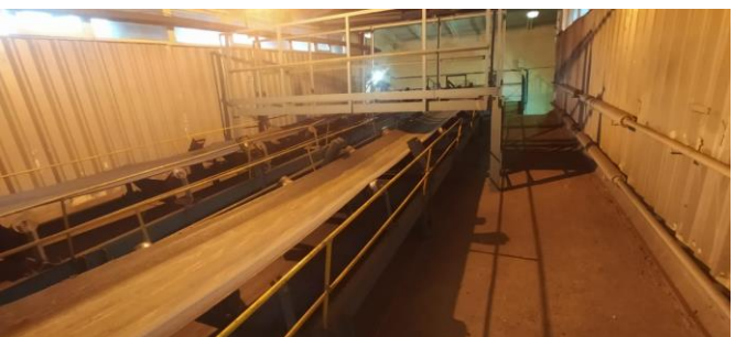
Конвейер для транспортировки осадка после отжима в боксы для загрузки в КамАЗы
