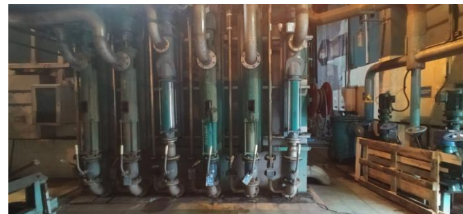
Группа насосов-дозаторов для подачи сырого осадка с бака осадка на фильтр-пресса
